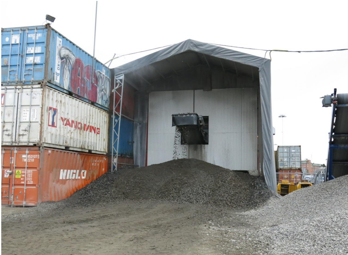
Figur 2 Exempel på en inklädd krossanläggning.
