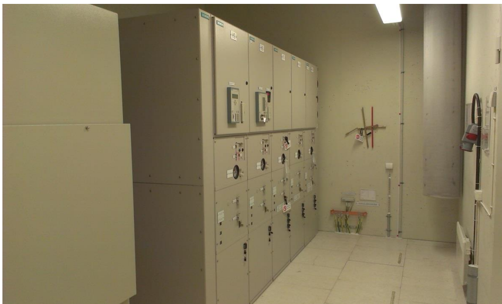
Bild 6.1: GIS-ställverk (Siemens) med 5 brytare i likriktarstation för Tvärbanan.
