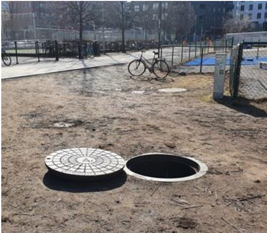
Figur 6.2. En infiltrationsanläggning under mark. I nedstigningsbrunnen finns styrordning för vattenflöde och el till frostskydd av vattenledningar.
