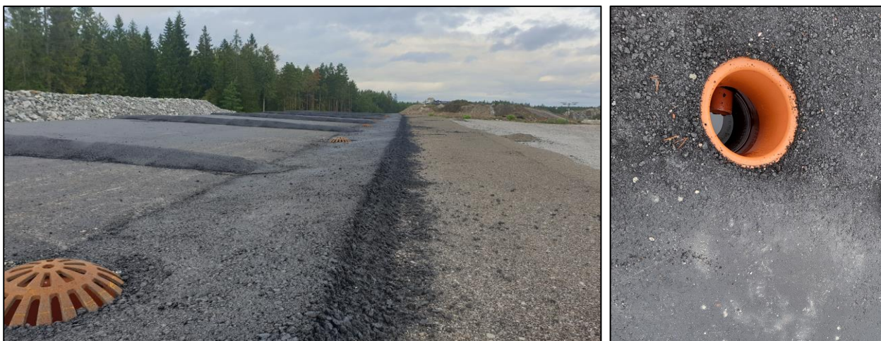
FIGUR 3. ASFALTERAD TESTYTA MED TILLHÖRANDE MARKANLAGDA BRUNNAR SOM SAMLAR UPP INRINNANDE LAKVATTEN AVSEENDE BERGHÖGEN FRÅN DE AVSKÄRMADA ASFALTSYTORNA. BILD TILL HÖGER VISAR BRUNN MED UTLOPPSRÖR I SAMBAND MED FÄLTMÄTNING.
