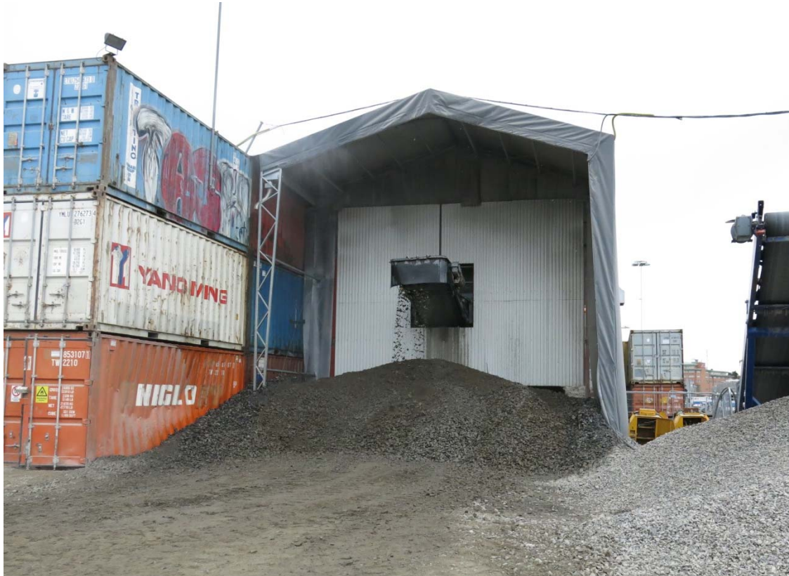
Figur 1 Exempel på en inklädd krossanläggning.
